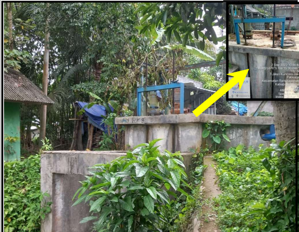
Lokasi Rencana Optimalisasi Intake: Pengadaan Pompa Intake Submersible Q=50 lps, H = 30 m, w/c, Panel dan pengkabelan dan Meter Induk Electromagnetic Ø12"
